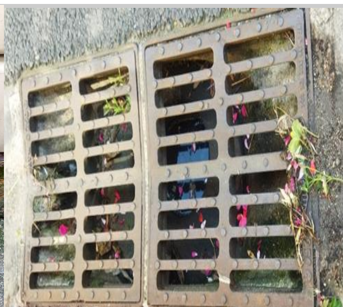
LES AVALOIRS BOUCHES
